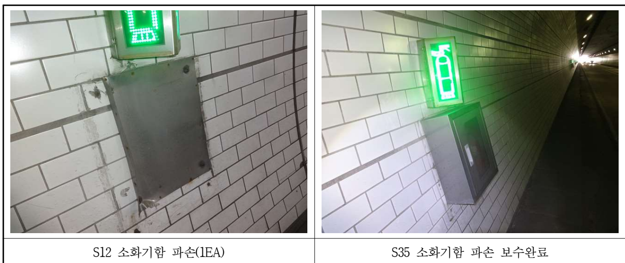
【사진 3.16】 터널 부속시설 손상현황
